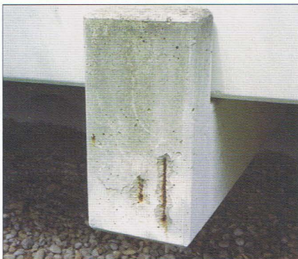
Chloridkorrosion an einem Stahlbetonkragarm
